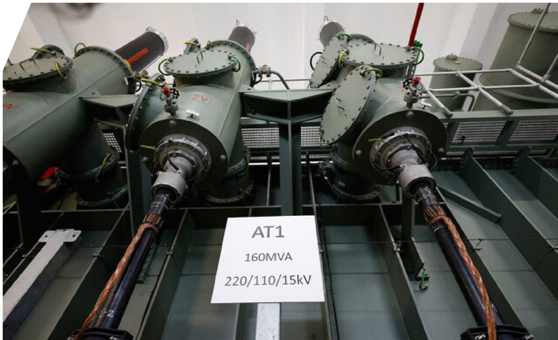
Stoen Operator, Stacja elektroenergetyczna Towarowa
