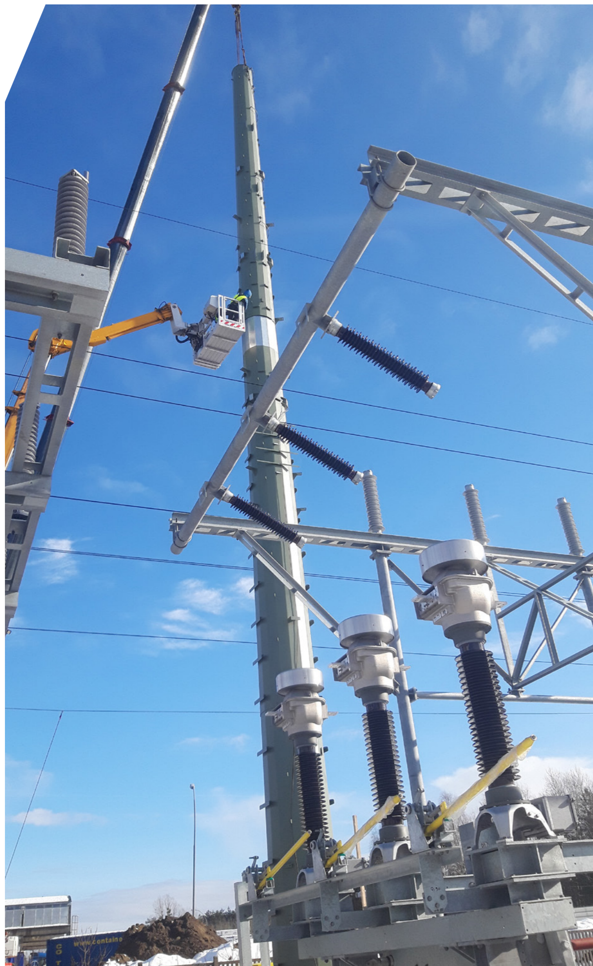
PGE Dystrybucja: Przebudowa słupa linii WN w celu wykonania nawiązań liniami kablowymi 110 kV do rozdzielni sieciowej 110 kV Budy Głogowskie
